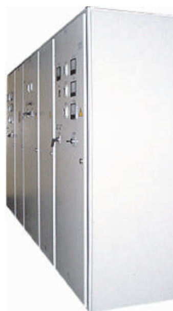
Панели распределительных щитов одностороннего обслуживания ЩО70
